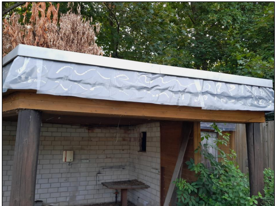
Foto 14: Unterseitige Folie auf der Vorderseite des Unterstands (Foto vom 01.07.23).
