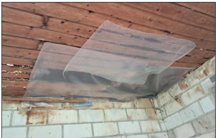
Foto 20: Lochverschluss des ehemaligen Amselbrutplatzes im Innenbereich des Unterstands (Foto vom 01.07.23).
