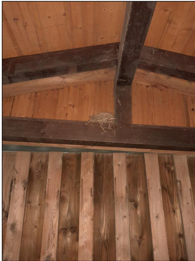
Foto 9: Vogelnest im vorderen, überdachten Teil des Saunagebäudes (Foto vom 17.04.23).
